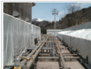
バッキ槽を覆うシート
